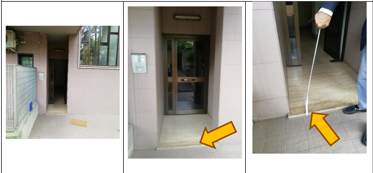
Accesso Ingresso androne con presenza di un gradino H = 4 cm
